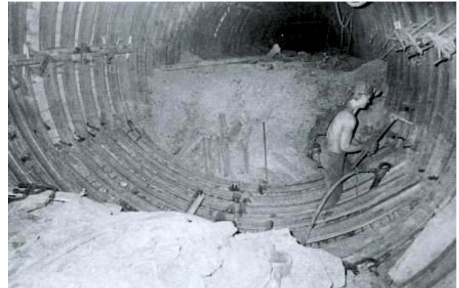
Flambage du mur dans une galerie minière polonaise, à 955 m de profondeur, et réalisation d'une contre-voûte ( photos B. Kozek et P. Gluch )
