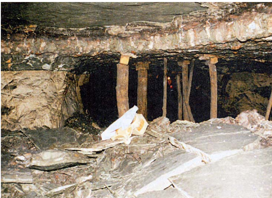
Chute de toit dans une carrière de gypse triasique du Jura. Les étais en bois soutiennent difficilement la dalle de toit. ( extrait de Evaluation des aléas liés aux cavités souterraines, INERIS, LCPC ).
