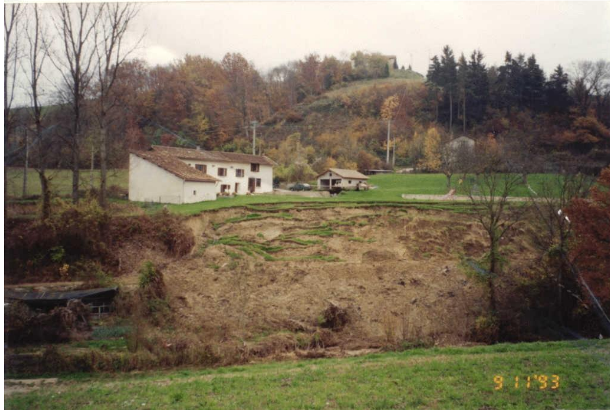
Glissement rotationnel dans un sol argileux (combe des Eparres, Isère). Photo D. Mazet-Brachet.
