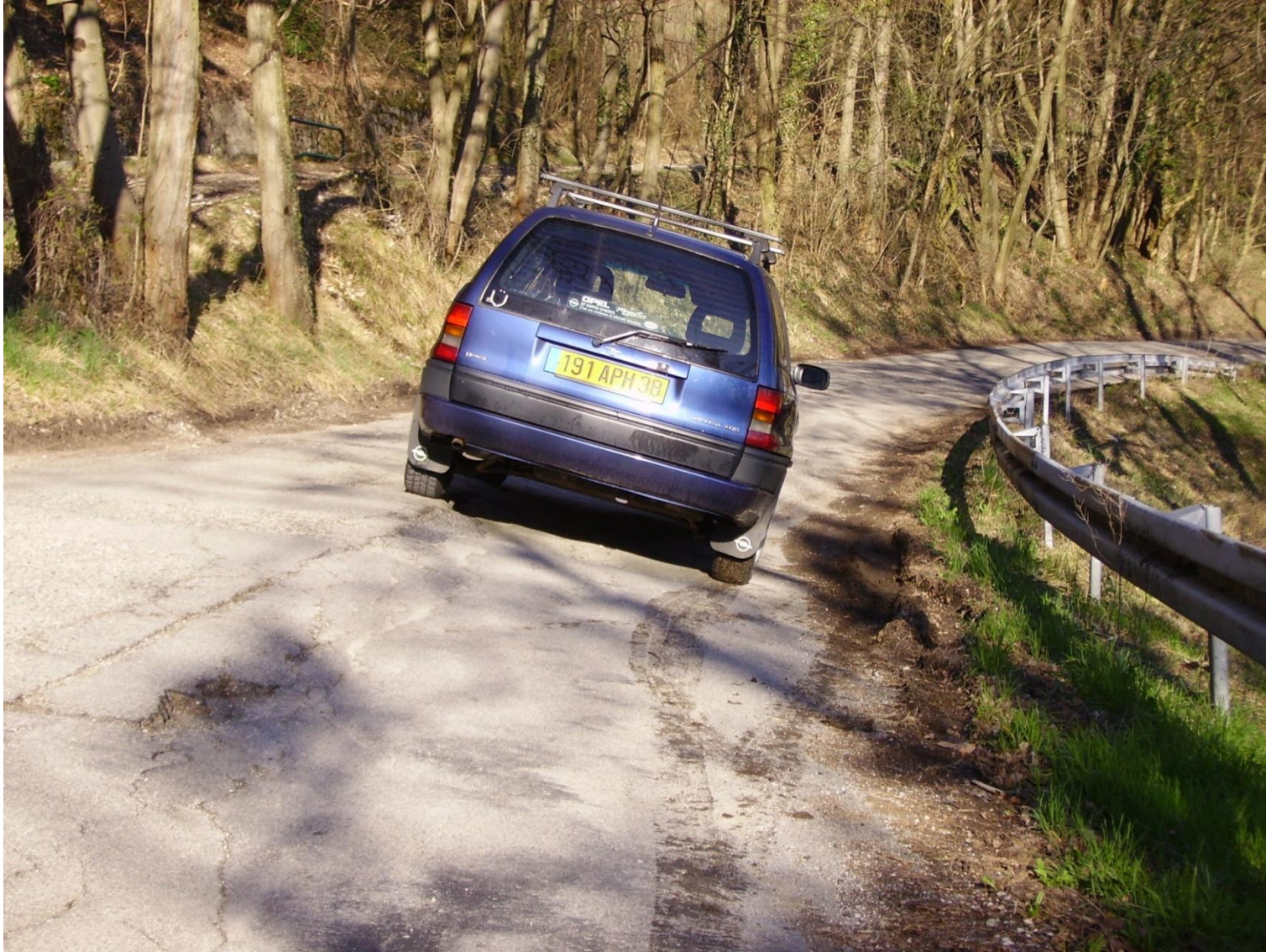
Route déformée par le fluage du versant (Seyssins, Isère).
