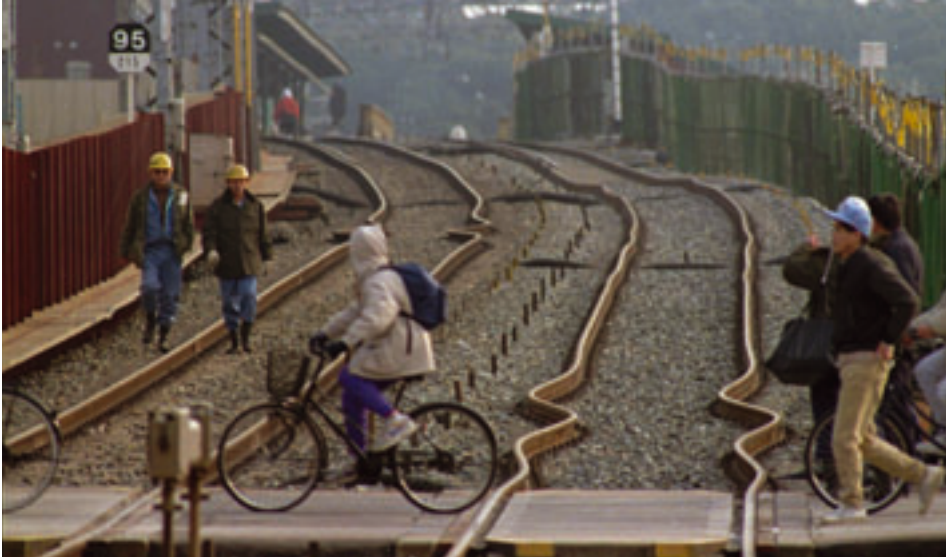
À NISHINOMIYA, près de la ville de Kobe au Japon, les voies ferrées ont été déformées par l'une des secousses secondaires qui suivirent le choc principal le 17 janvier 1995.
