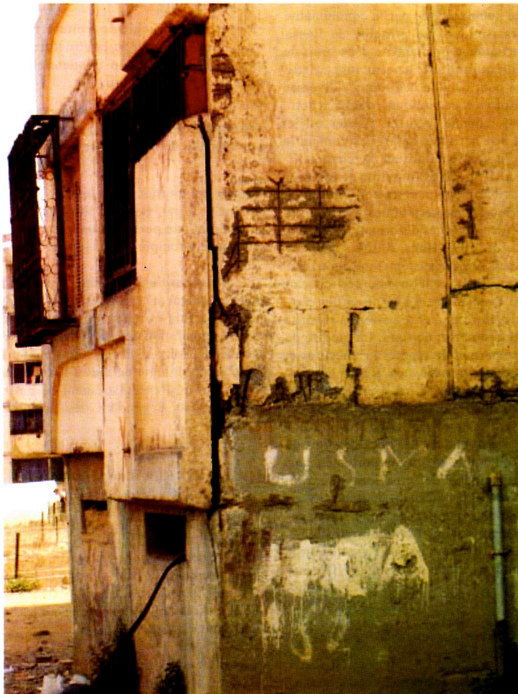
Fig. 7 - Photo du rez-de-chaussée d'un bâtiment de la cité des 800 Logements, mettant en évidence (1) la mauvaise qualité de la réalisation et de l'entretien de la structure avec l'apparition du treillis soudé sur les voiles en béton armé, et (2) des fissures provoquées par le séisme à la jonction des panneaux préfabriqués en béton armé avec la structure.
