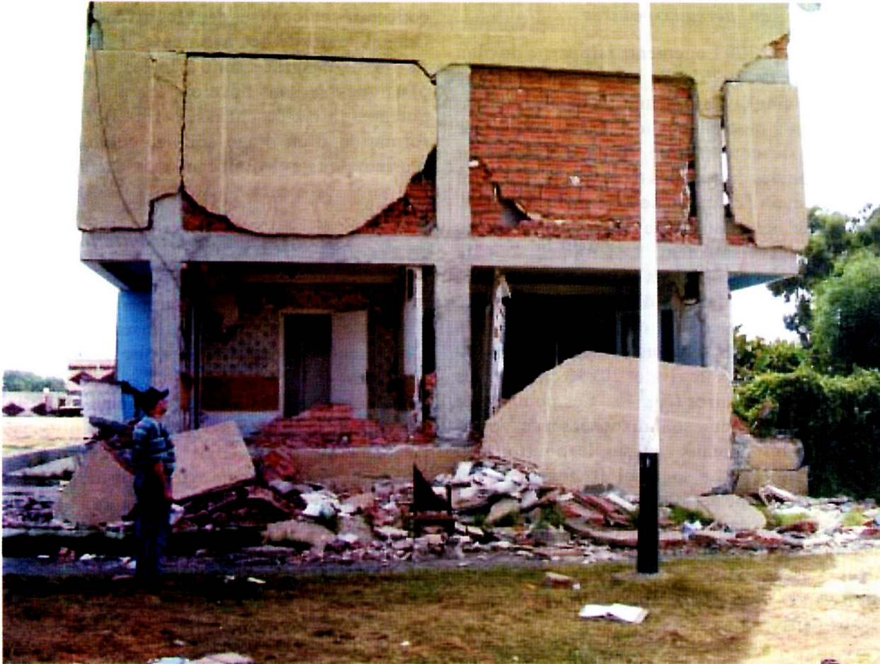
Fig. 2 - Photo du rez-de-chaussée d'un des bâtiment de la cité des 1200 Logements, mettant en évidence la rupture des remplissages en brique pour le système constructif en poteaux-poutres.
